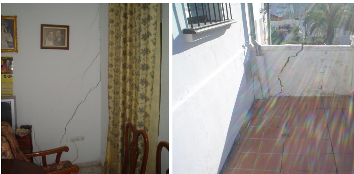
Fig. 17. Grietas en vivienda de calle Calzada. Fig. 18. Grietas en muro y hundimiento de solería.
