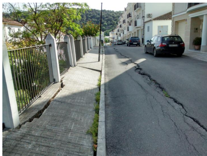
Fig. 16. Fractura del acerado y pavimento en calle Practicante Antonio Ríos.
