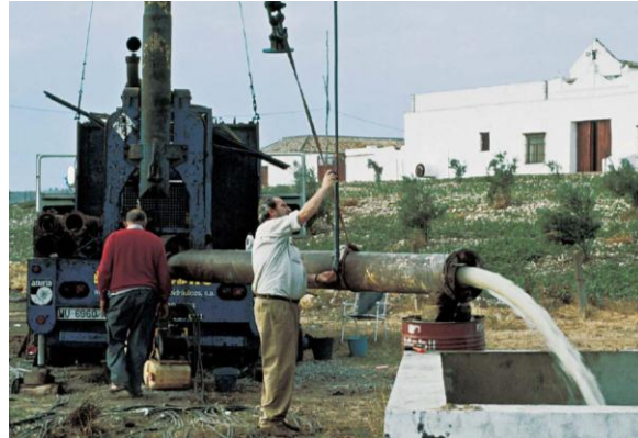
Fig. 29. Aforo en el acuífero de Arcos-Bornos-Espera. Sondeo de explotación Arcos III realizado en 1995 para el abastecimiento de emergencia de la Bahía de Cádiz
